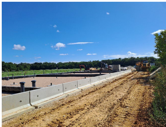
1 er étage de filtres plantés de roseaux
