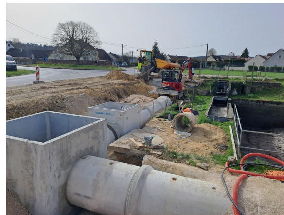
Zone d'arrivée des effluents/déversoir d'orage
