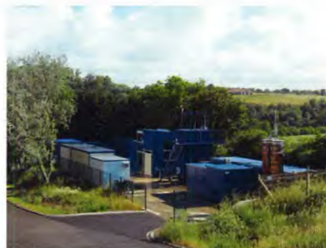
PLATEFORME « EAU POTABLE » DU JAUNAY (85)
