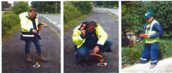
UTILISATION DE L'UTILISATION DES MOYENS SPÉCIALISÉS : PRÉLOCALISATEUR ACOUSTIQUES / CANNE D'ÉCOUTE / RECHERCHE AU GAZ
