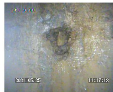
Suintements autour de 10 m de profondeur
