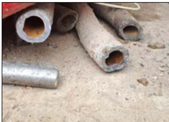
Photo d'un branchement en plomb
